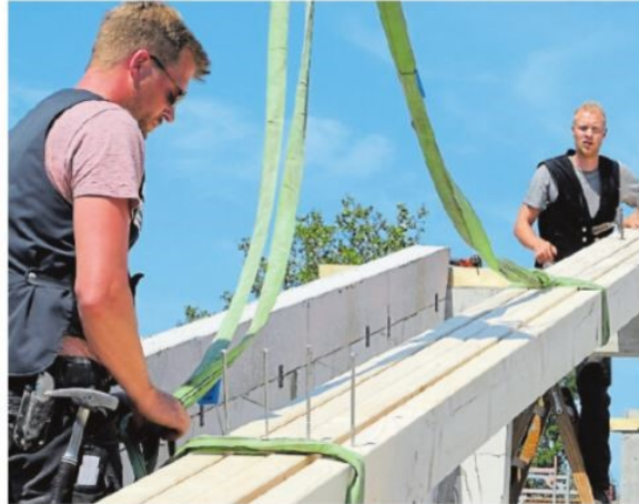
Das langersehnte Holz ist da: Anfang der Woche konnte der Bau des Dachstuhls der OBW-Kita starten
