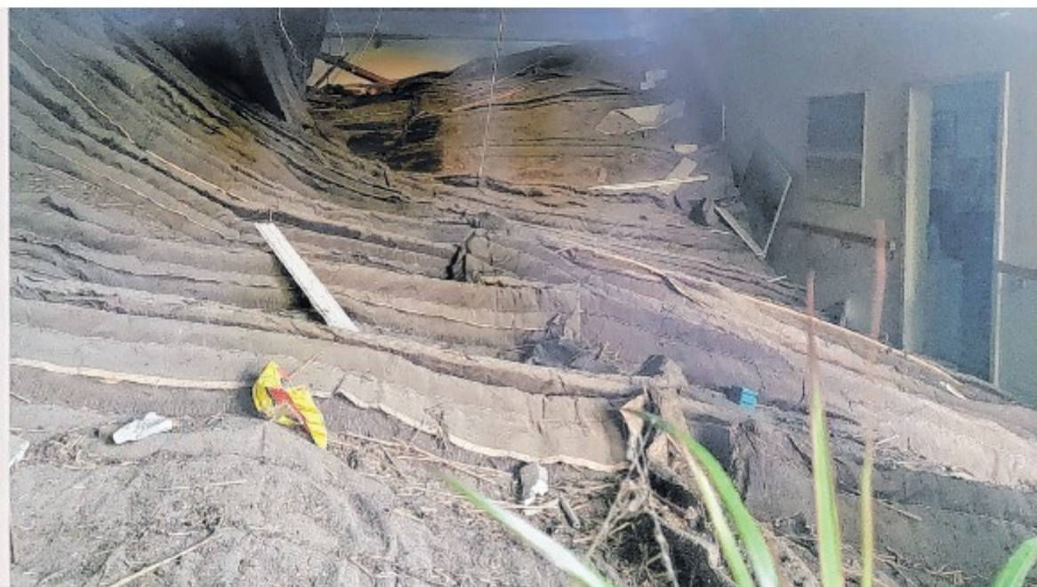
In einem Gemeinschaftsraum stürzte die komplette Decke ein.
