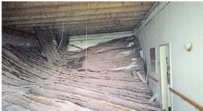
Plötzlicher Einsturz: Die 20 Bewohner waren nur 30 Minuten zuvor im Gemeinschaftsraum
