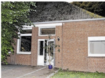
In diesem Gebäudeteil der Wohnstätte ist die Decke eingestürzt. FOTO: LUPPEN
