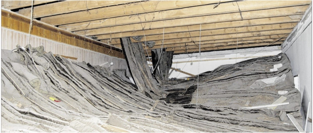
Die Zwischendecke im Aufenthaltsraum der Wohnstätte ist herabgestürzt.
