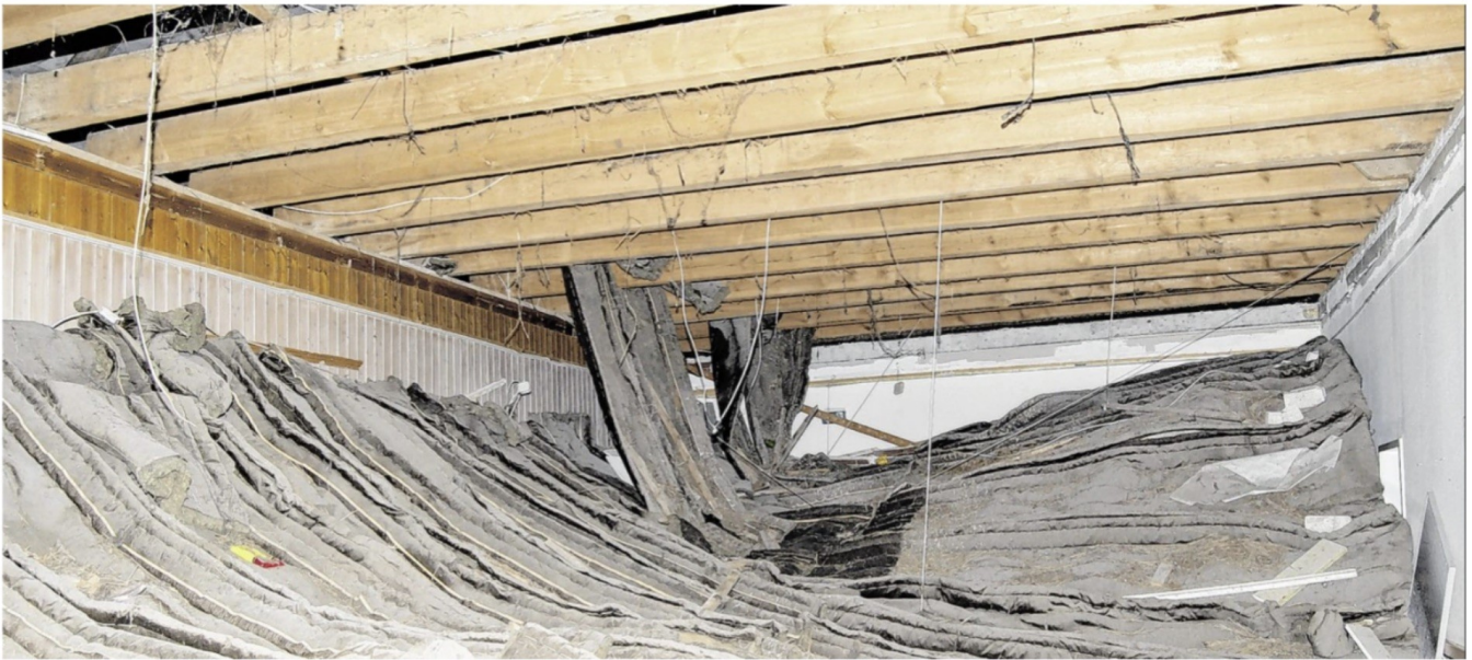
Die nachträglich eingezogene Zwischendecke machte sich am vergangenen Donnerstag selbstständig.
