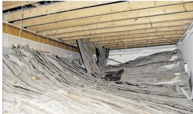
So sah es aus, nachdem die Decke der OBW-Wohnstätte in Bedekaspel heruntergekommen war. Glücklicherweise war der Aufenthaltsraum leer. FOTO: ARCHIV/LUPPEN
